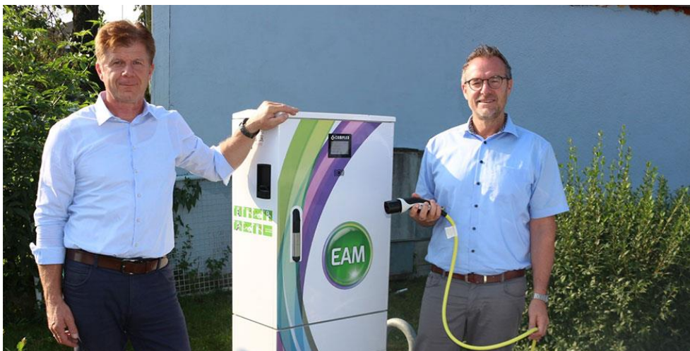
Abbildung 31: Inbetriebnahme Ladesäule Parkplatz Breitwiese durch Armin Schülbe (Leiter EAM Regionalzentrum Nord) und Bürgermeister Thomas Eckhardt
