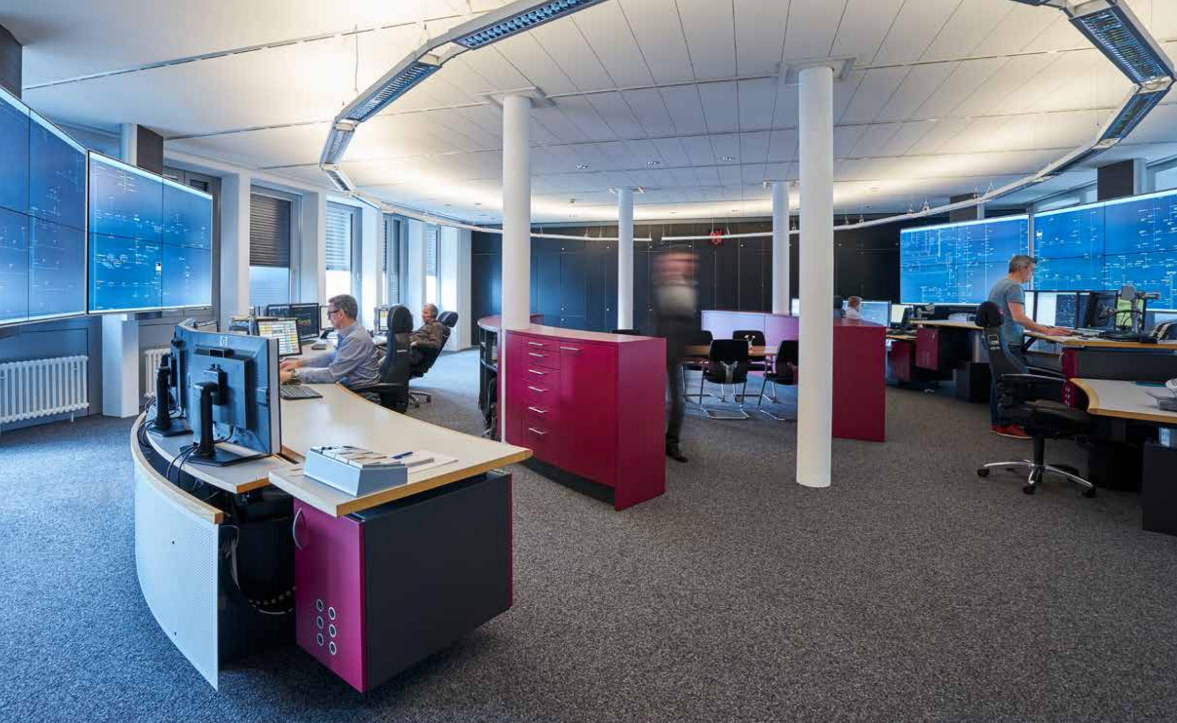
Die EAM-Netzleitstelle in Baunatal wurde neu gestaltet und modernisiert.
