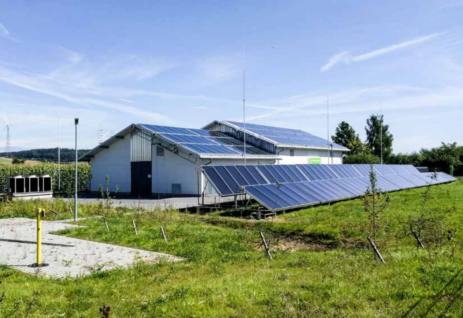
In der Gasdruck-Regelanlage der EAM in Malsfeld-Ostheim erfolgt die bei der Druckreduzierung notwendige Erdgaserwärmung vorwiegend durch Solarthermie.
