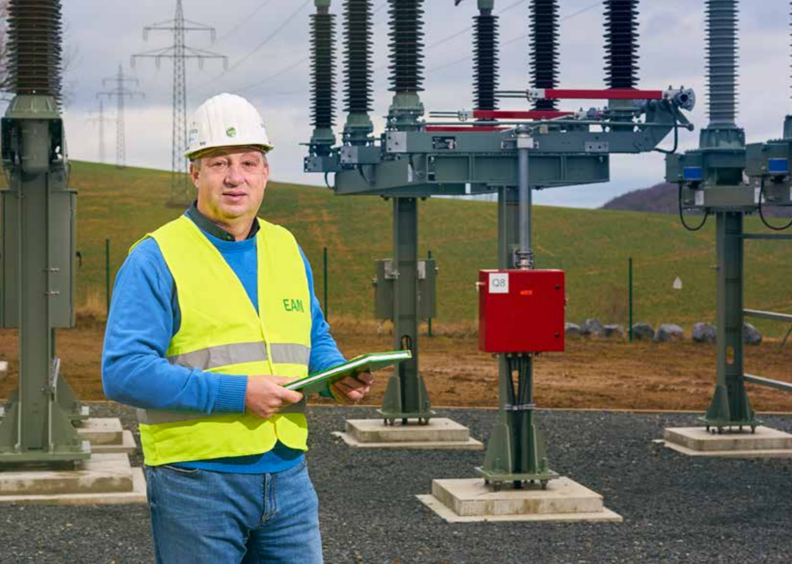
EAM-Projektleiter Klaus Adam im Umspannwerk Drammetal, das seit August 2016 in Betrieb ist.
